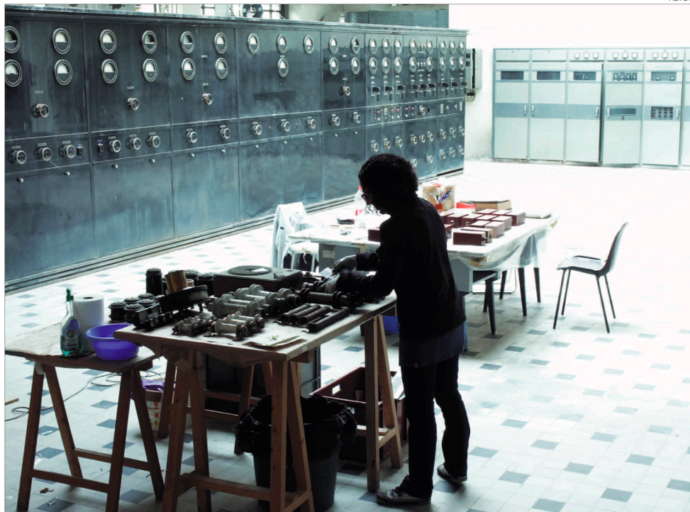
► A l'esquerra, l'emissor del 1939, que va emetre ininterrompudament fins al 1981; al fons, el Brown Boveri del 1963.
